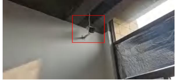
内部视频监控系统
